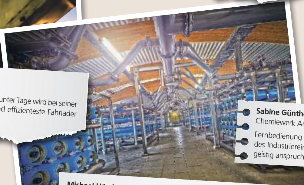
Michael Hörken Wasserwerk Löhnen Die Stadtwerke Dinslaken GmbH verfügen mit dieser Nanofiltration über eine der modernsten Anlagen zur kommunalen Trinkwasseraufbereitung in Europa.
