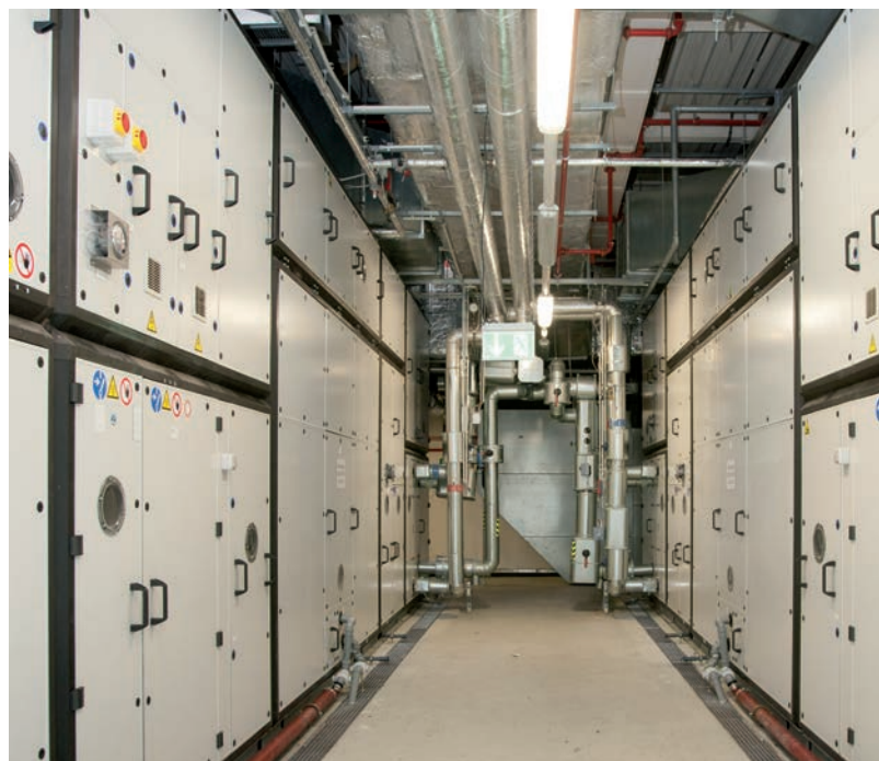
Menerga-Geräte im Fraport (Foto: Menerga)
