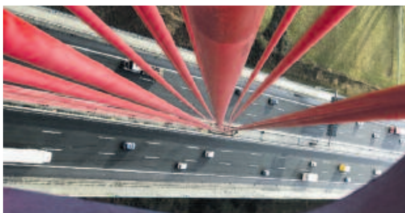
Arbeiten in schwindelerregenden Höhen: Hier findet eine Prüfung an Brücken-seilen statt. (Foto: mtl)
