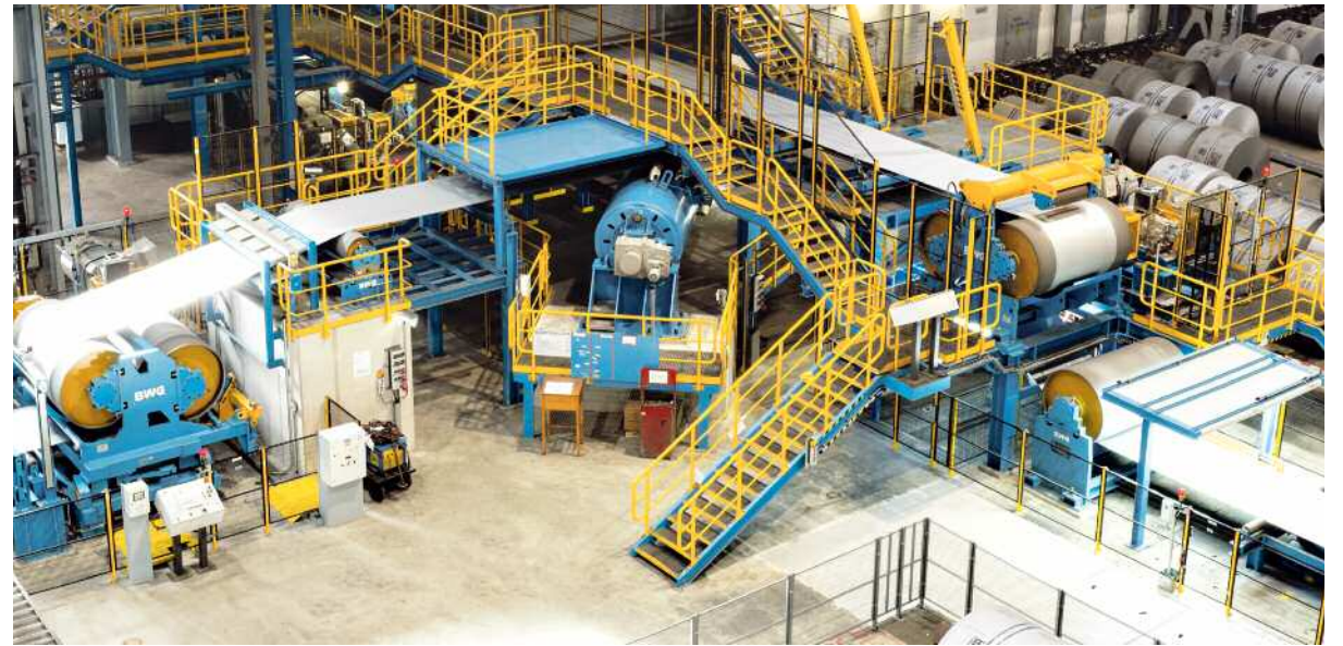
Eine BWG-Anlage bei der Salzgitter Flachstahl: kontinuierlicher Einlaufteil zum Tandem-Kaltwalzwerk (Foto: BWG)
