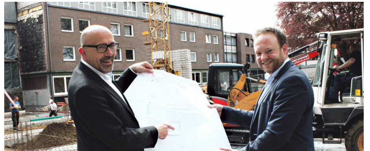
Baustelle neben dem Bocholter Europa-Haus: Berthold Klein-Schmeink (links) und Christoph Hollmann planen den funktionalen Neubau als „Haus der Begegnung“. (Foto: Middelkamp)
